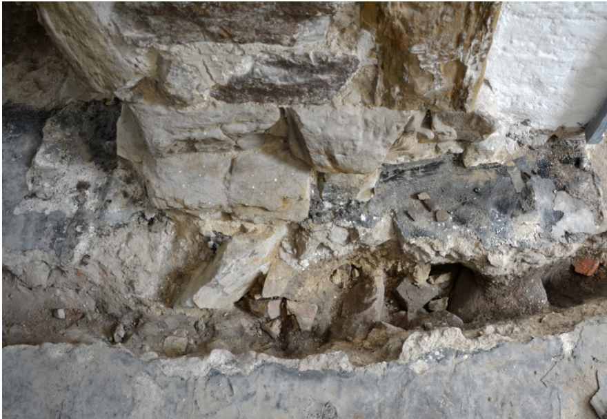
Figur 8. Ledningsschaktet vid östra arkadpelarens fundament. I botten av schaktet syns sträckmuren i form av en kallmurning med gråsten. Uppe på tjärpappen ligger de tre keramikskärvorna som påträffades vid rensningen. Under arkadpelaren gav metalldetektorn utslag för ett större järnföremål.
